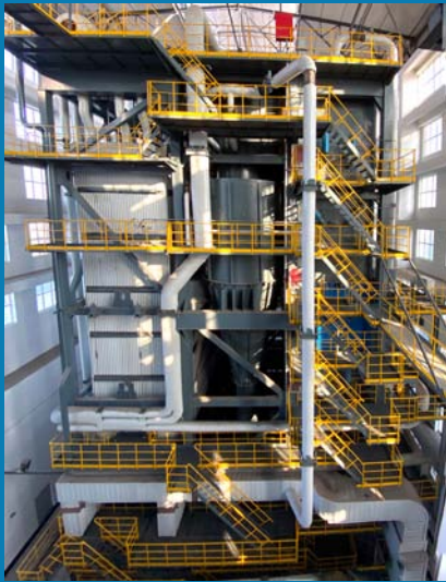
70MW 水煤浆循环流化床锅炉
