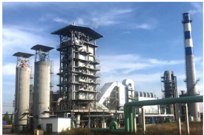
60t/h 煤粉预热燃烧锅炉
