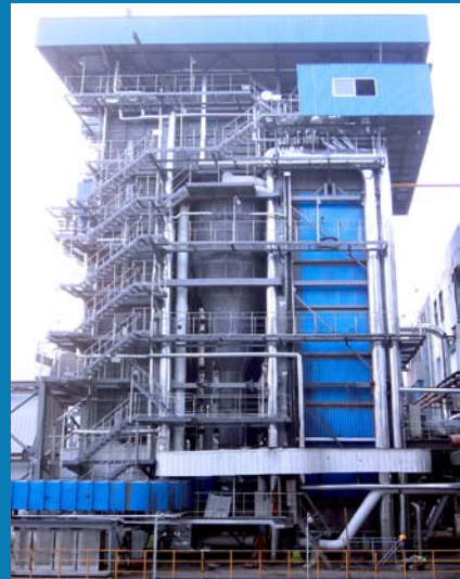
75t/h 煤泥循环流化床锅炉
