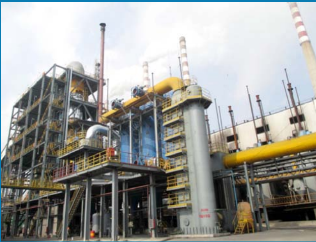
40000Nm 3 /h 空气气化项目
