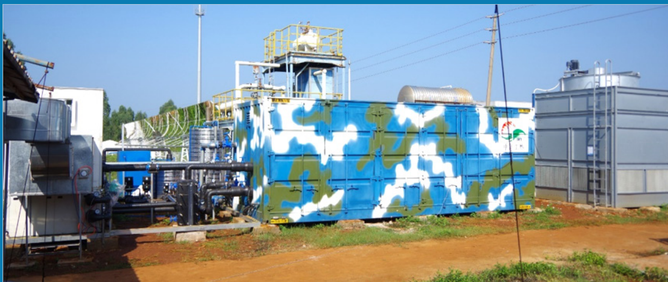
余热制冷除湿脱盐技术验证系统
