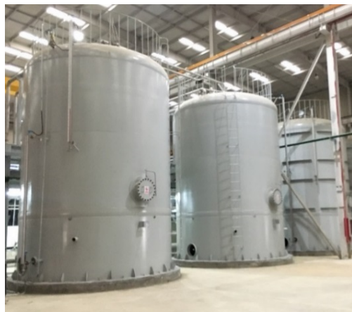
20MWh 亚临界水储热系统
