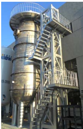
10GJ 填充床储冷装置
