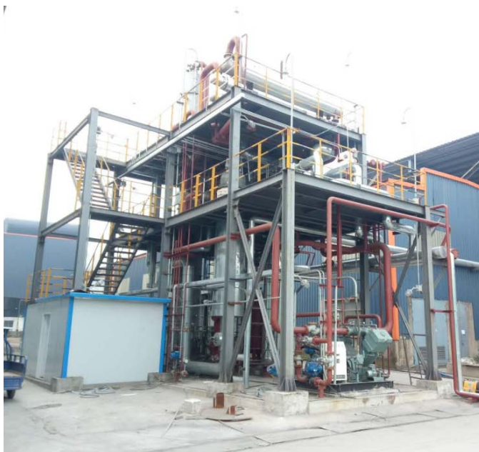
100 千瓦级热化学储能 / 化学热泵示范平台
