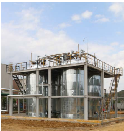
10MWh 导热油储热装置
