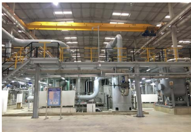
国际首套 10MW 示范系统（贵州毕节，2016）
